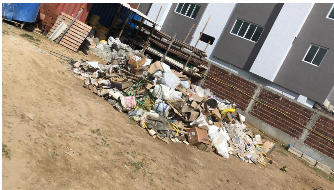
Figura 9: Acúmulo de resíduos em obra, sem segregação e disposição adequada.
