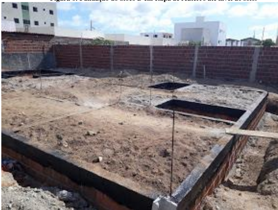
Figura 6: Fundação do bloco D em etapa de reaterro até nível do solo.
